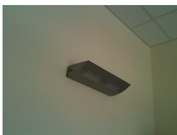
Figura 28 - plafoniera a muro (degenze)
