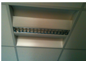
Figura 27 - plafoniera da incasso nel controsoffitto
